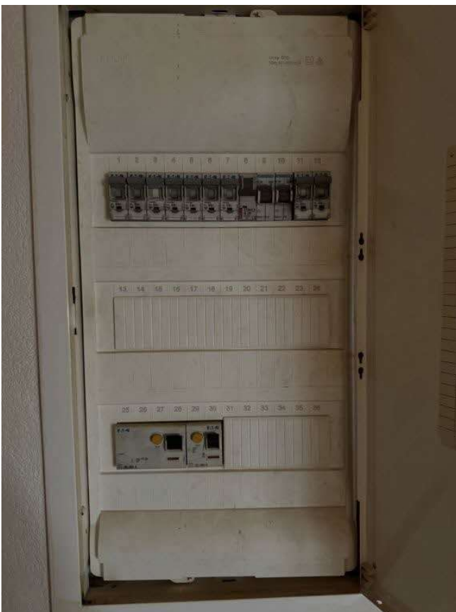
teilweise neue Elektrik
